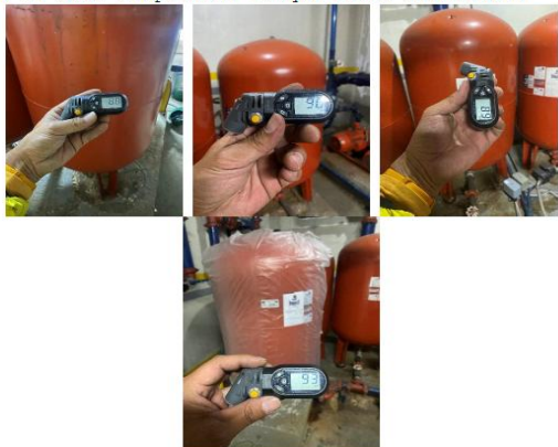
carga de aire comprimido tanque hidro acumulador
